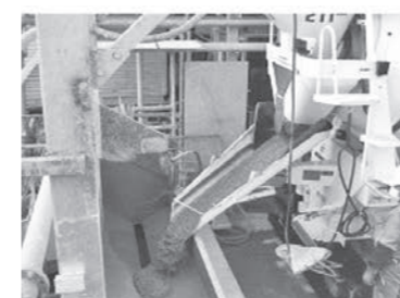
戻りコンクリート
